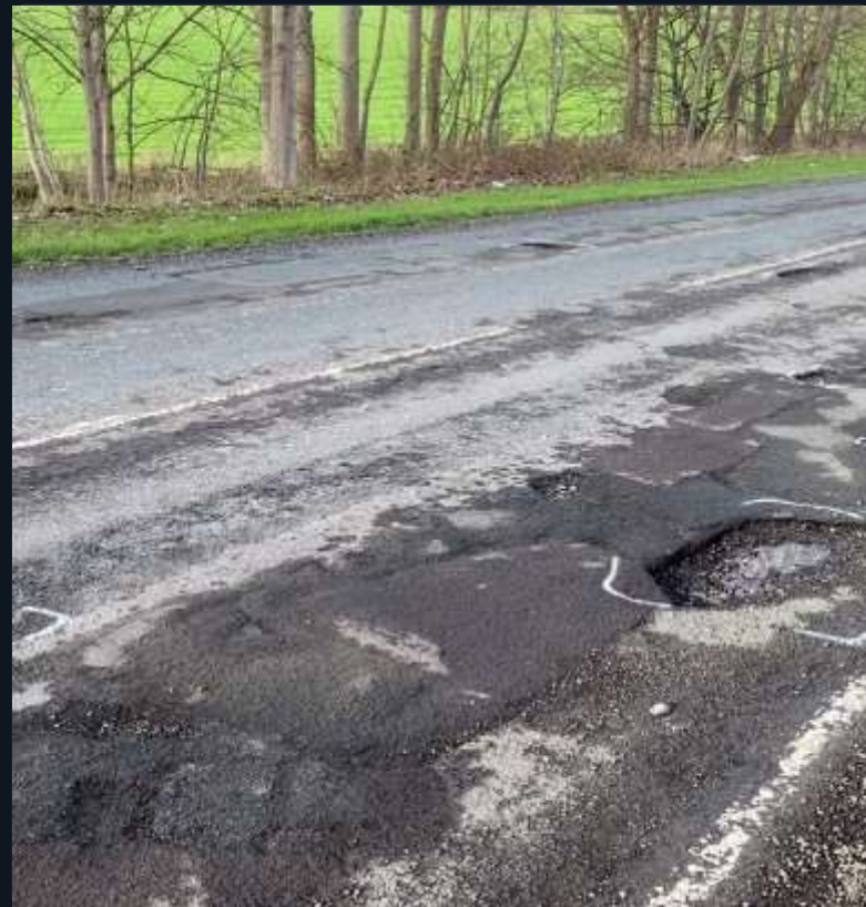
Пример фрагмента с дефектами: трещины и выбоины, подлежащие классификации моделью
